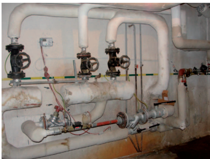
Węzeł ciepłny przed remontem w budynku nr 6 przy ul. Tuwima.
