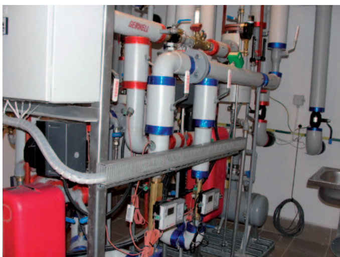
Nowy, wysokoparametrowy węzeł ciepłny G-Power firmy GEBWELL sp. z o.o. do systemu ogrzewania i przygotowania ciepłej wody użytkowej dla budynku nr 6 przy ulicy Tuwima.
